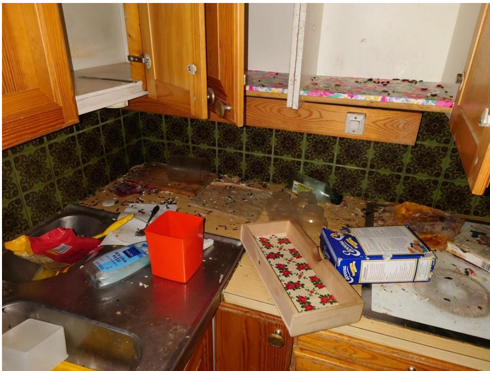
Kuva 2) Keittiön välitilan laatoitus ei sisällä asbestia. Rakennus on ollut kylmillään useita vuosia, kohteessa havaittiin useassa paikassa jrsijöiden ulostetta ja kuolleita jrsijöitä.
