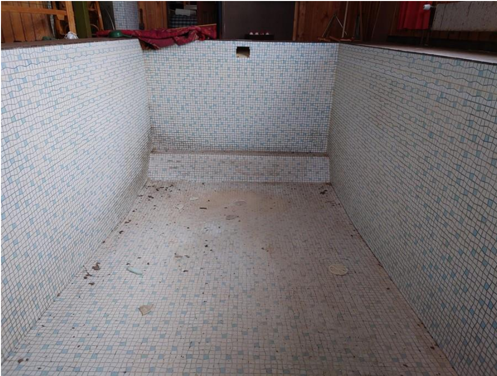
Kuva 3) Uima-altaan laatoitus sisältää asbestia.
